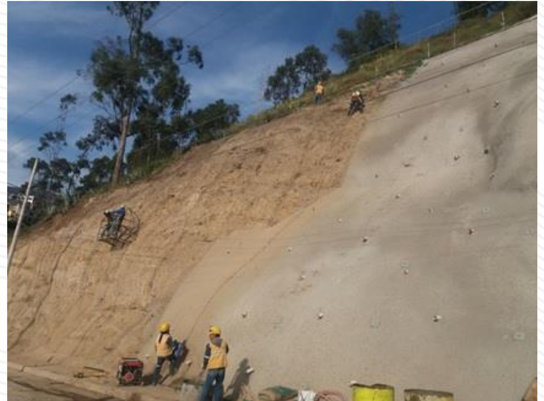
Taludes calle Edmundo Martínez
